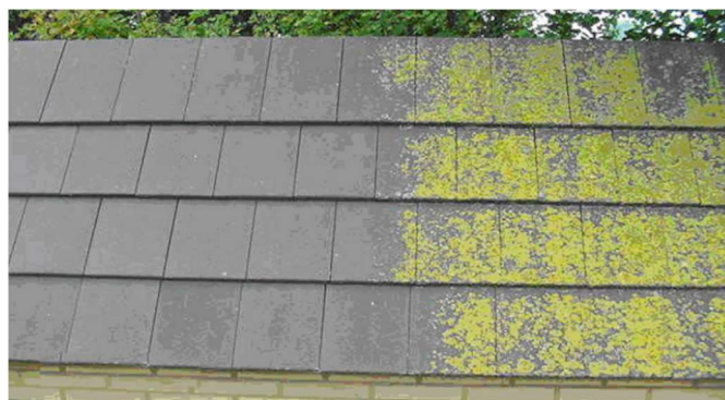
MossKade va à l'encontre des lichens
